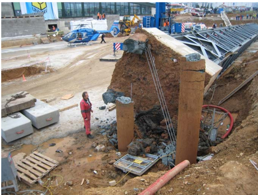
Obr. 10. Porušení pilotového základu
